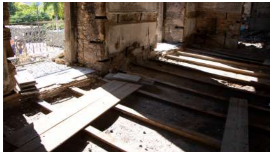
Chão da sala Culturas do Pacífico, que não ruiu ou desabou / Floor of the Pacific Cultures room, which did not crumble or collapse.
