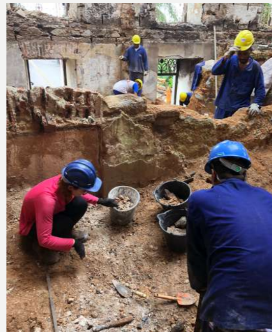
Escavação na área da coleção de Carcinologia após o incêndio / Excavation in the area of the Carcinology collection after the fire.
