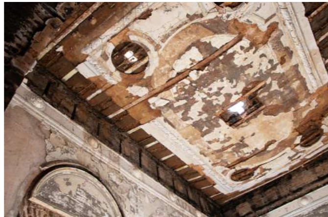
Teto da sala Culturas do Pacífico, que não ruiu ou desabou / Ceiling of the Pacific Cultures room, which did not crumble or collapse.
