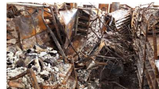
Exemplo de armários compactadores da Coleção de Paleovertebrados que foram esmagados pelo peso dos andares superiores / Example of compactor cabinets of the Paleovertebrate Collection that were crushed by the weight of the upper floors.
