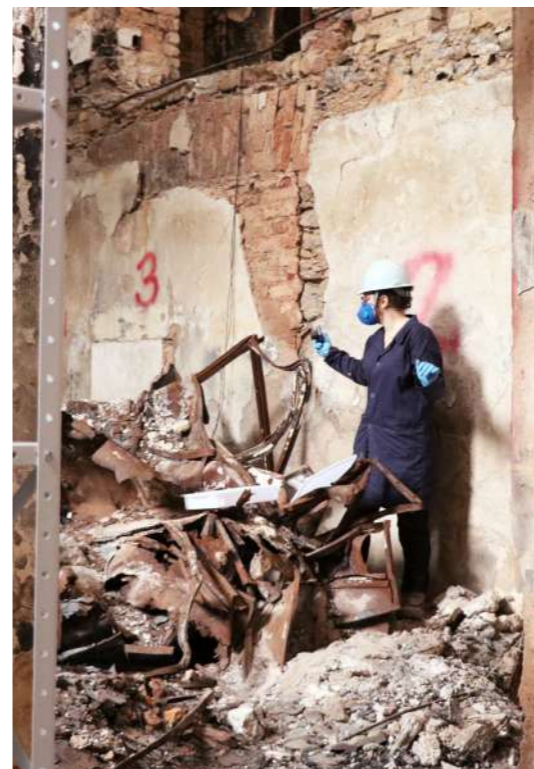
Resultado da queda do terceiro andar / Result of the collapse of the third floor.
