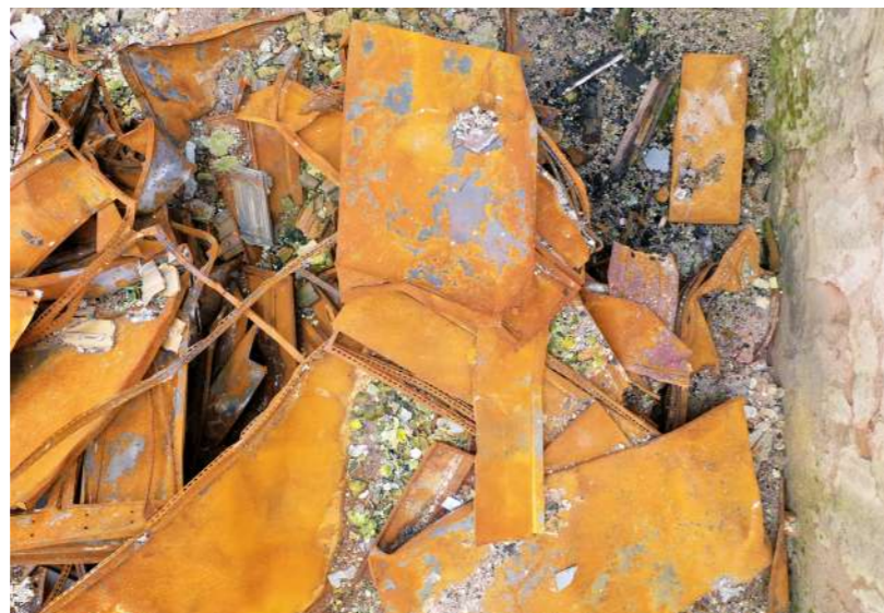
Resultado da queda do terceiro andar / Result of the collapse of the third floor.
