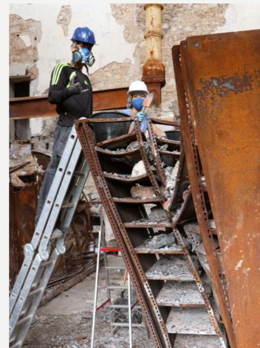
Acesso ao topo dos armários compactadores retorcidos, para o resgate dos minerais / Access to the top of the twisted compactor cabinets, for the rescue of the minerals.
