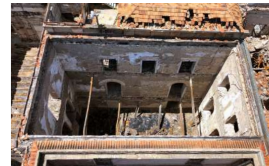
Imagem mostrando a ausência dos telhados após o desabamento / Image showing the absence of roofs after the collapse.
